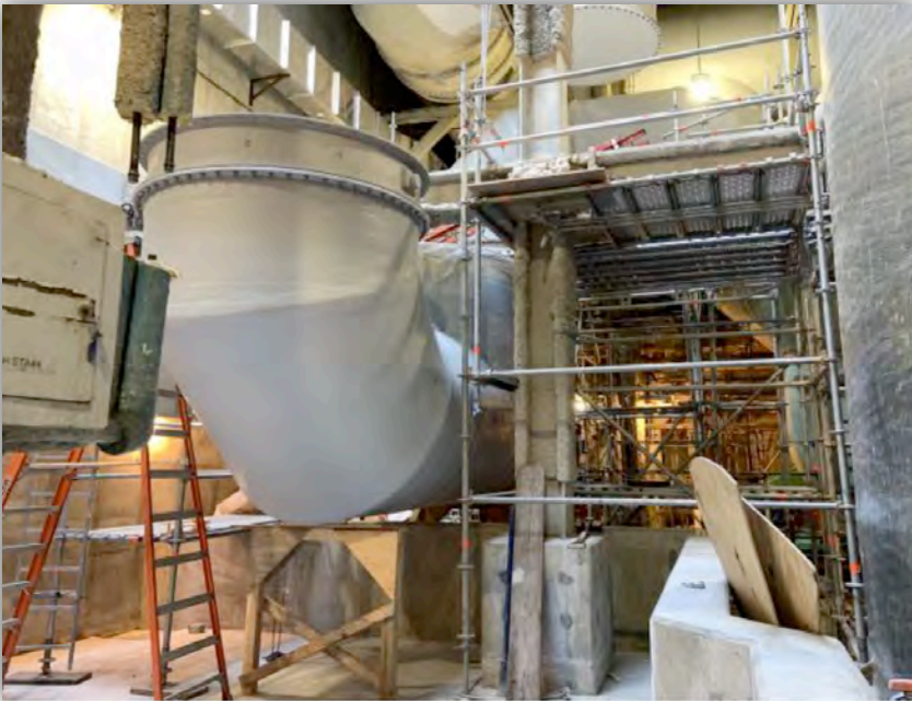
Ductwork Odor Control Fan #4
